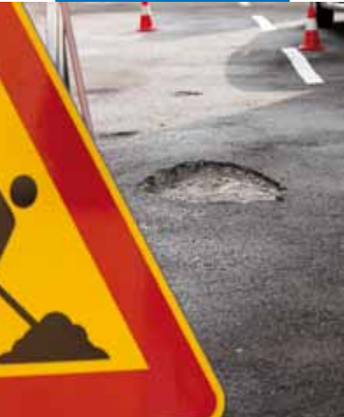
Buca stradale pronta per essere riparata
